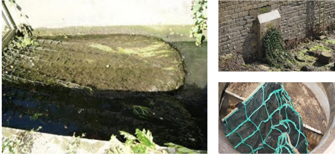
Figura 12: Redes de retención instaladas en Brest Métropole en cursos de agua, salida de aguas pluviales y alcantarillas (Fotografías OiEau)
