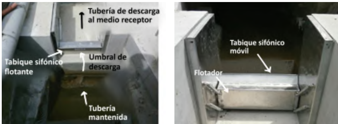
Figura 14: Ejemplo de mamparo sifónico móvil para retener residuos flotantes (Fuente: HYDRASS-3D agua)
