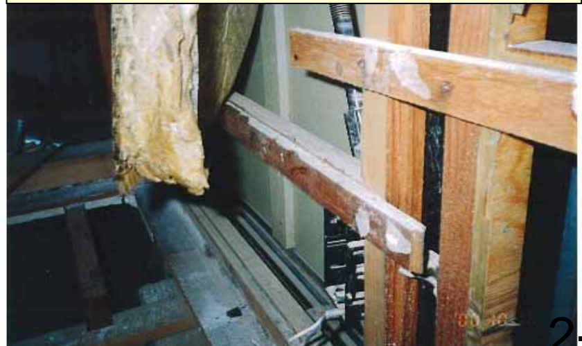
Isolants thermiques imbibés d'eau et inutilisables
